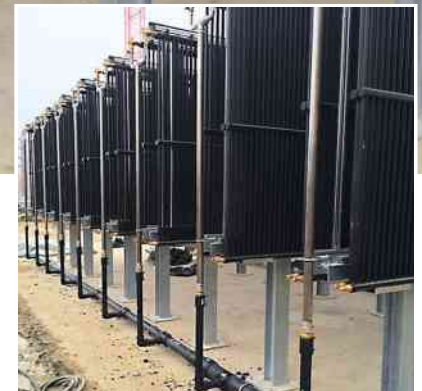
Die Solar-/Luft-Absorber sind über dem Eisspeicher platziert und befinden sich zwischen zwei der fünf Gebäude des Neustudenparks in Amriswil. (Bild: Curiger Immobilien AG)
